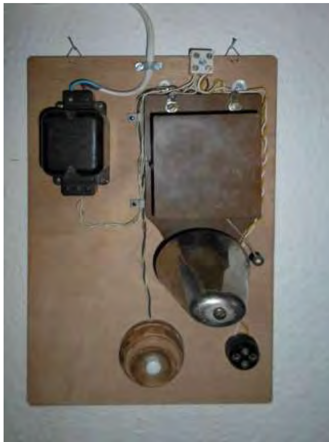
Bild 12: Schalttafel mit alter Klingel und Holzklingelknopf sowie Mini-Steckdose
